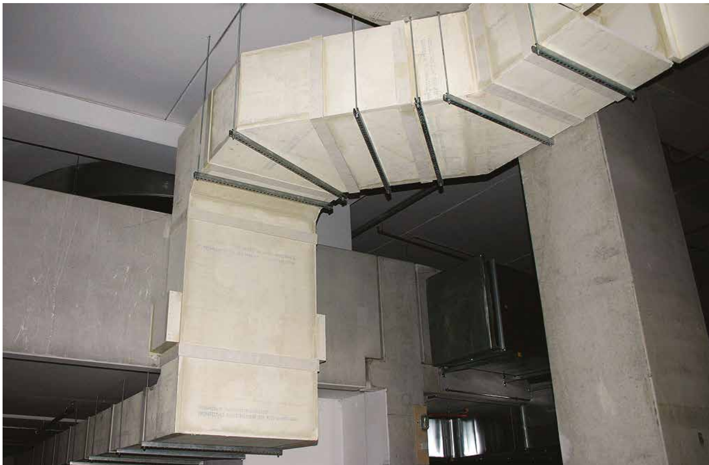
Ventilační potrubí z desek PROMATECT®
