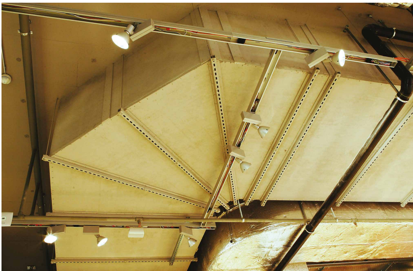
Ventilační potrubí z desek PROMATECT®
