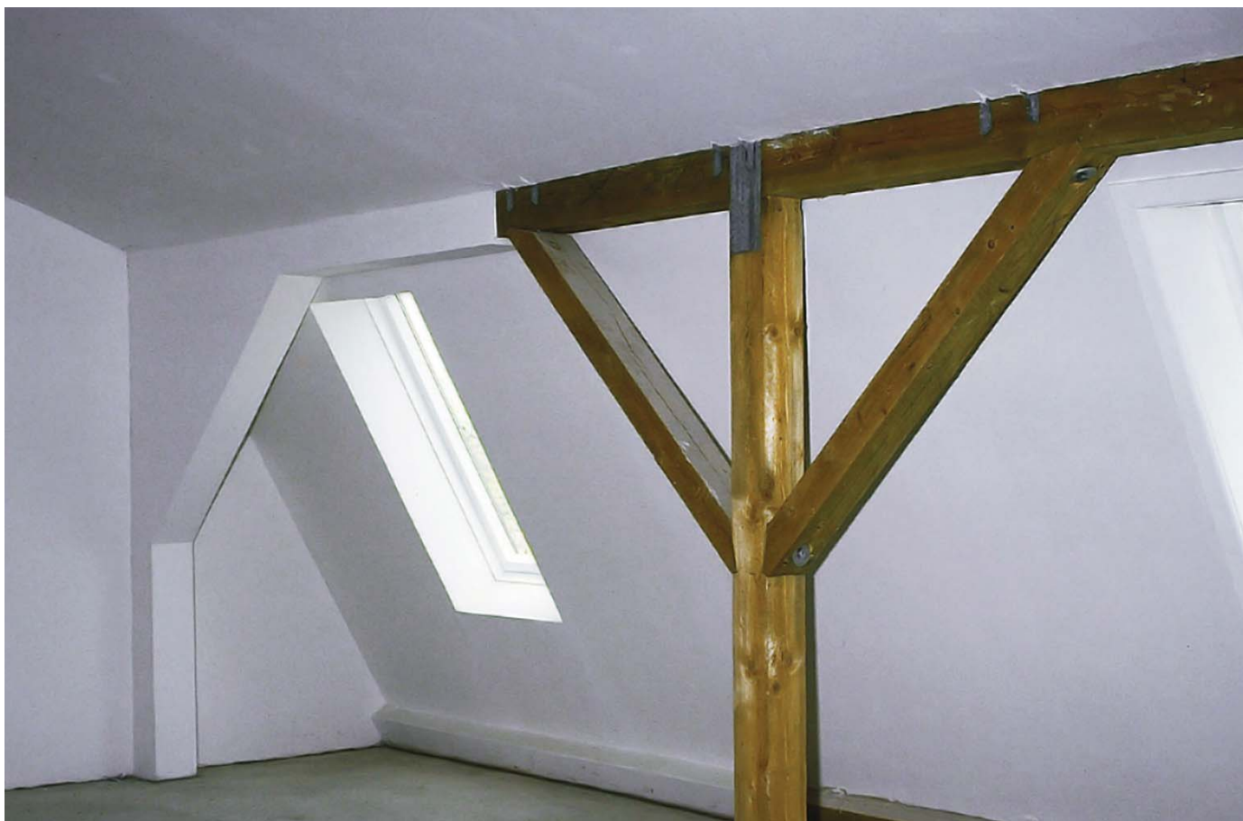
Podhled PROMATECT® pod střešní konstrukcí
