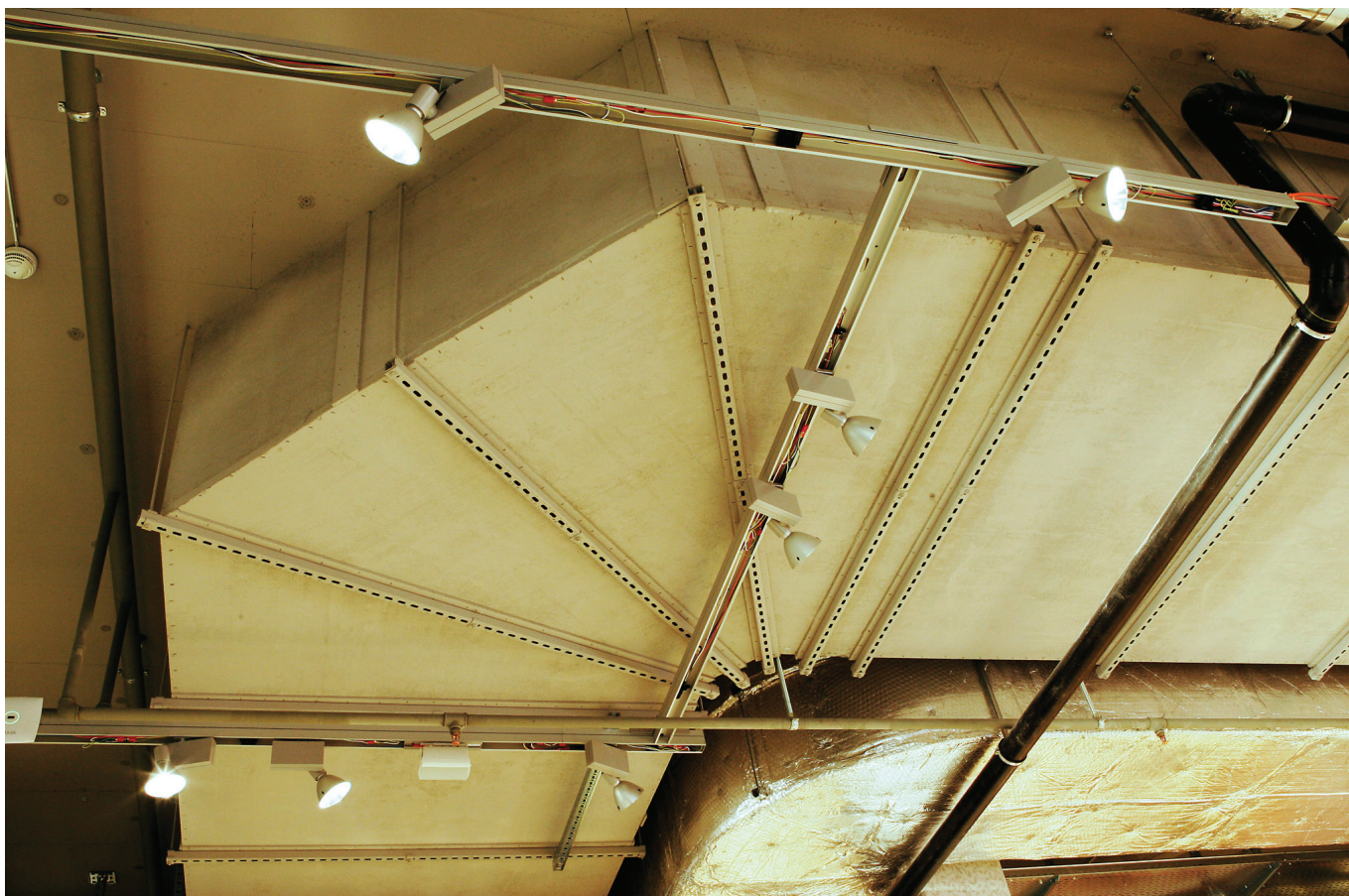
Ventilační potrubí z desek PROMATECT®
