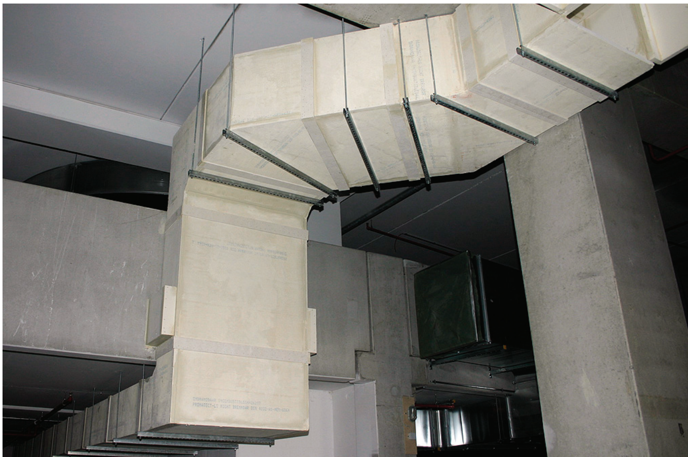
Ventilační potrubí z desek PROMATECT®
