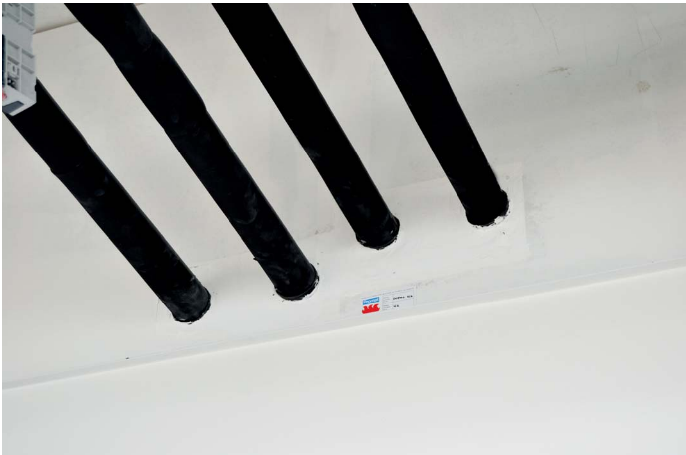
Prostupy potrubí s požárně ochranným pásem PROMASTOP®-W
